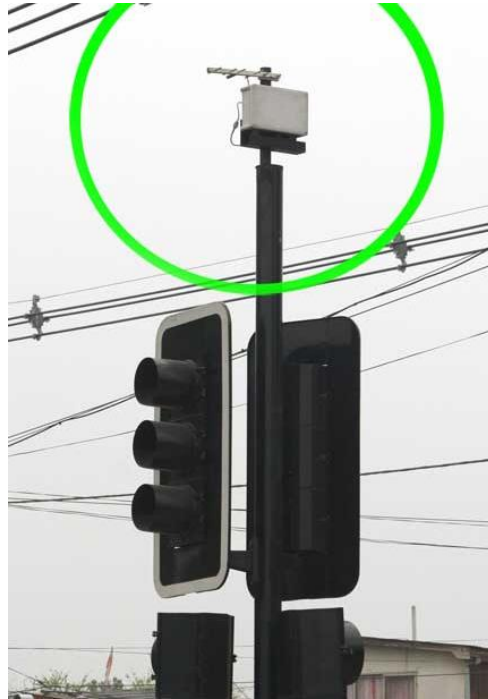
Antena yagi UHF para telecontrol de semáforos
