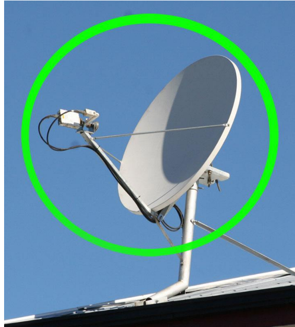
Antena VSAT para tx de datos
