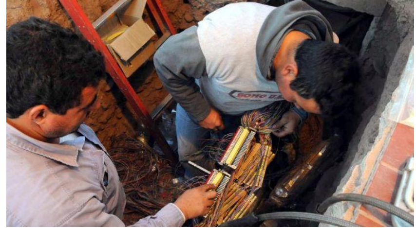
Empalme de cable multipar
