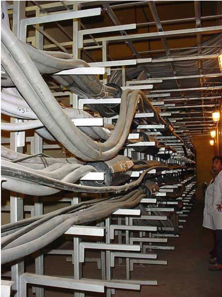
Túnel de cables
